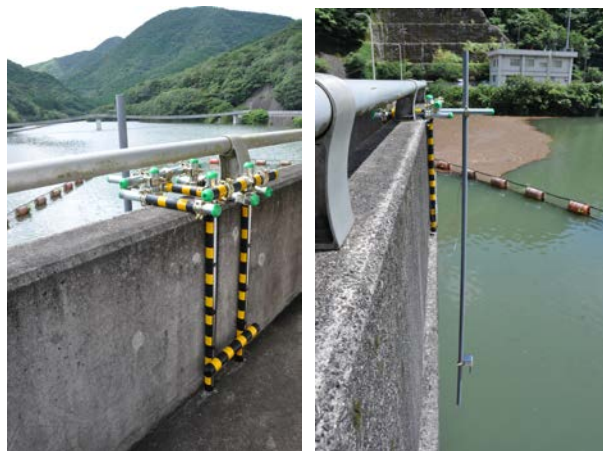
(a) 小型水位計架台 (b) 塩ビパイプと小型水位計
