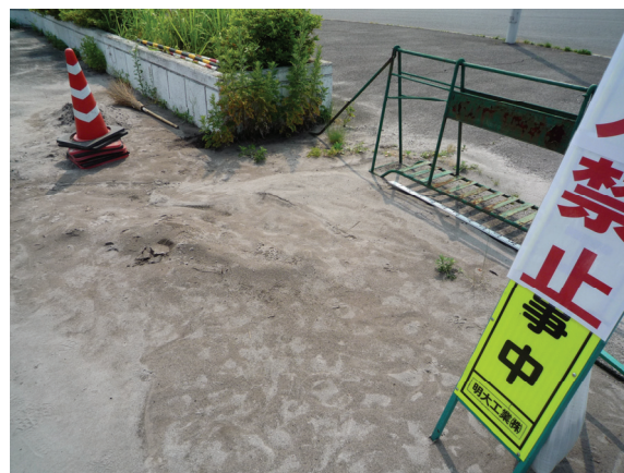
写真-1 熊本地震(本震)による別府観光港の液状化による噴砂の状況(2016年5月27日撮影)
